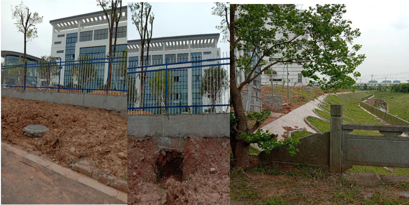
雨、污水总排口
